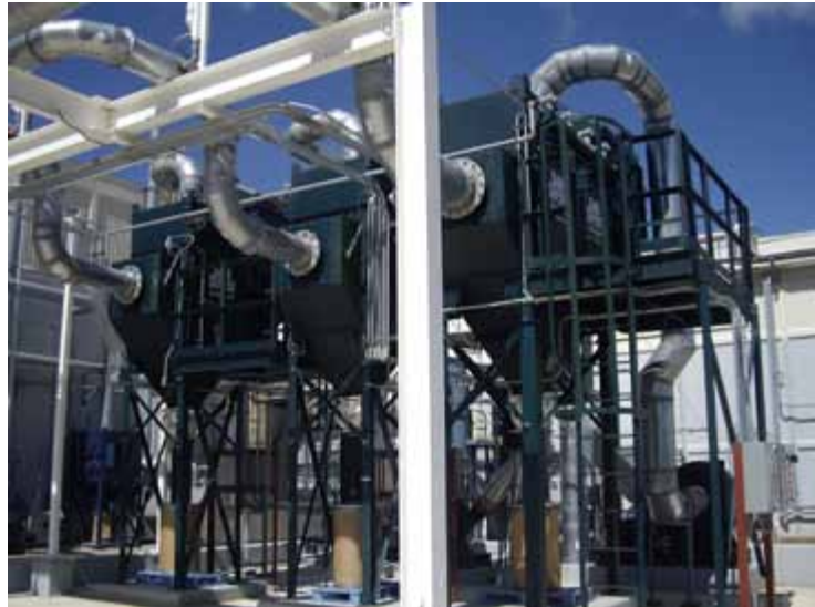
Collecteurs de poussières de la Gold Series utilisés sur un applicateur de comprimés dans une grande entreprise pharmaceutique.
