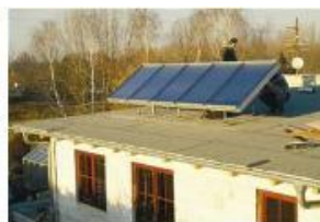
Les capteurs sur châssis en toiture-terrasse
