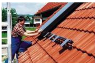
Les capteurs superposés à la toiture
