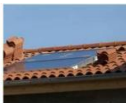
Les capteurs intégrés à la toiture
