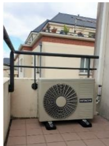
Unité extérieure de mono split disposée en balcon
