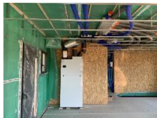
PAC sur air extrait avec ventilation double flux + réseau de gaine de ventilation (soufflage et extraction)
