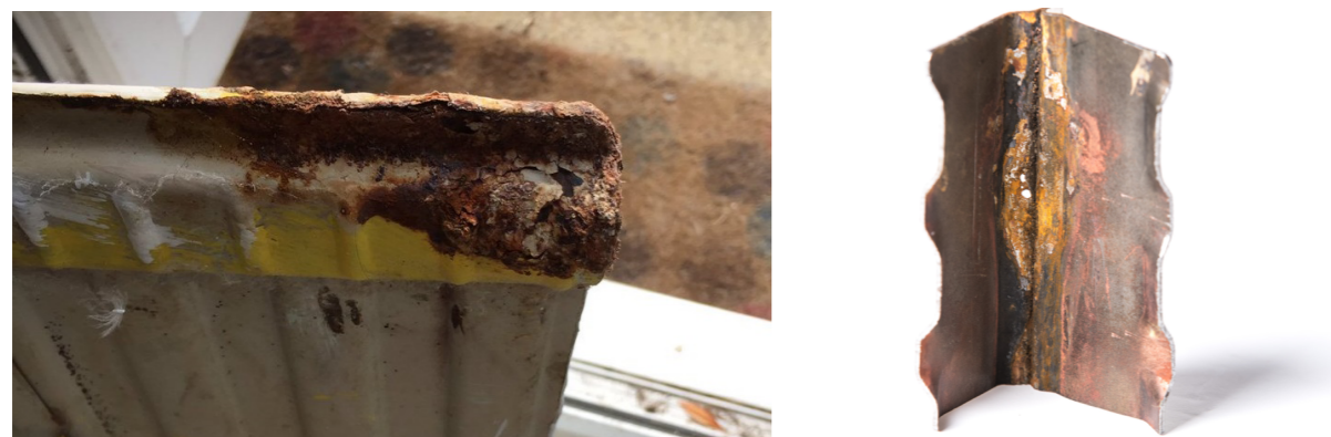
CORROSION PERFORANTE SUR RADIATEURS EN ACIER VUE EXTÉRIEURE (À GAUCHE) ET VUE INTÉRIEURE (À DROITE)
