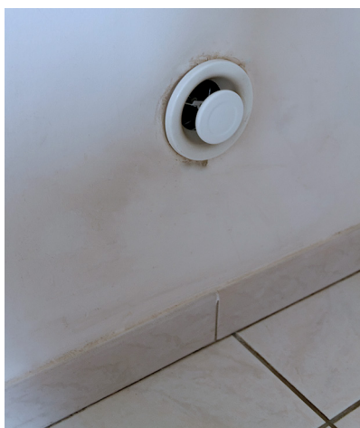
▲ Figure 14 : Exemple d’une bouche de soufflage située à 30 cm du sol et insufflant de l’air chaud à des températures trop élevées (noircissement de la paroi à proximité) – Site n°1
