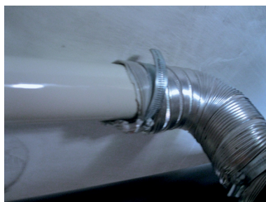
▲ Figure 18 : Raccord peu étanche entre le conduit de raccordement du poêle (souple) et le réseau aéraulique d’air chaud (rigide)
