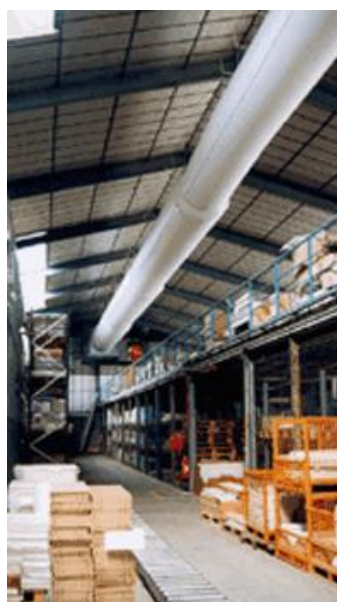
Texi-pulse dans une installation de bâtiment de stockage tissu polyester M1 blanc
