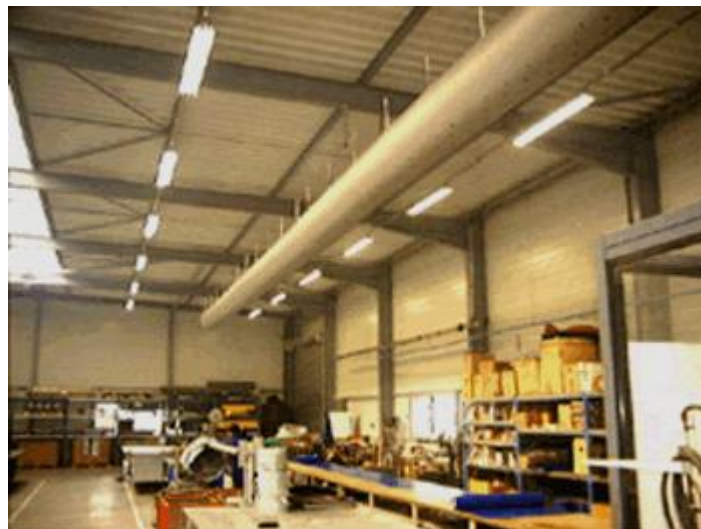
TEXI-JET dans une installation
