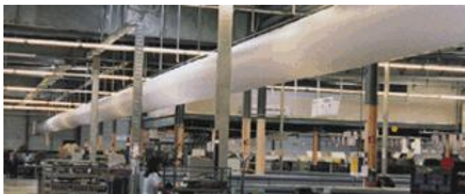
Texi-soft dans une installation
