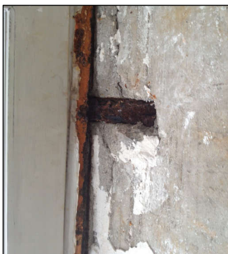
Corrosion des dormants et éclatement du béton
